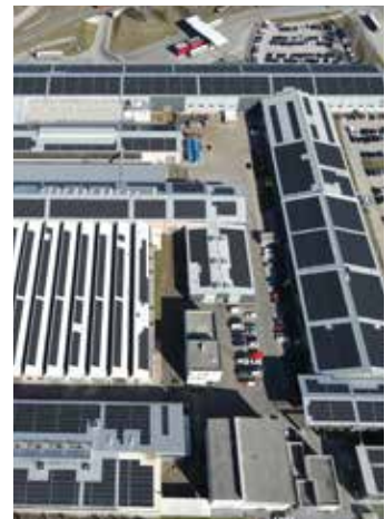
Abb.: PV-Anlage im Bereich der Muffenfertigung
