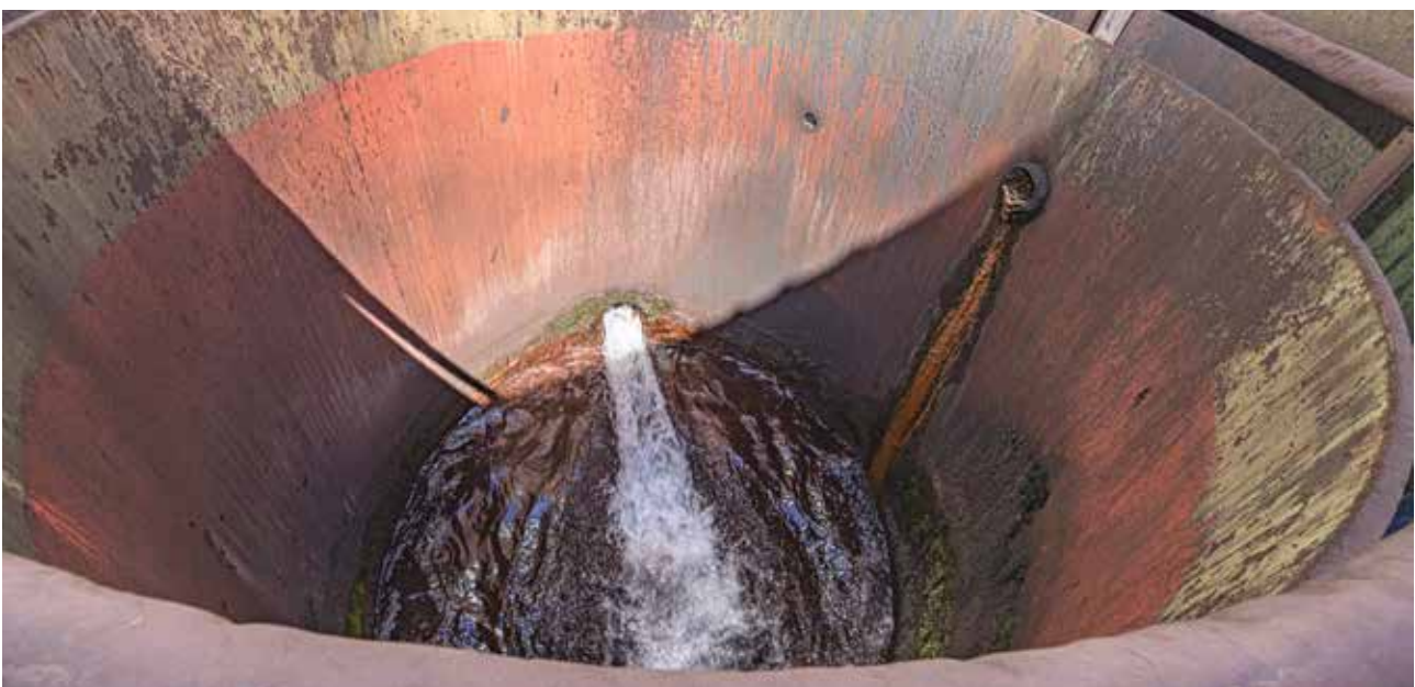
Abb.: Zunderfänger Wasserwirtschaft CT-Werk (Teilstrom 1)
