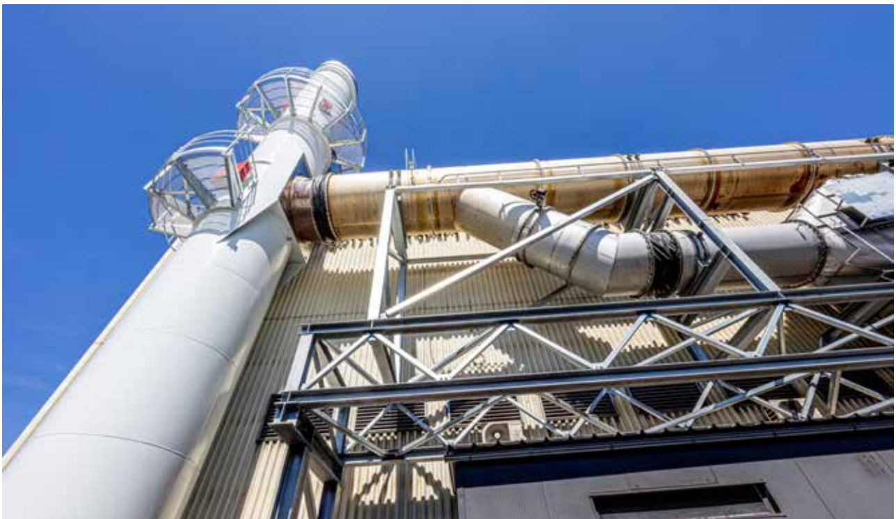
Abb.: DHO-Abgaskamin mit Wärmeauskopplung
